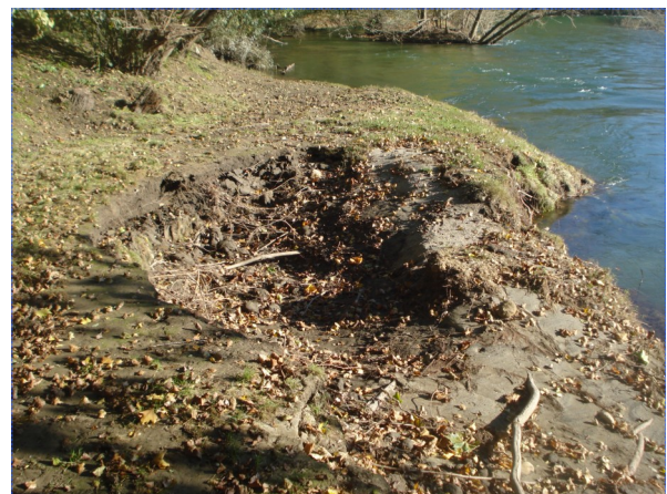
La berge du camping emportée par l'eau
